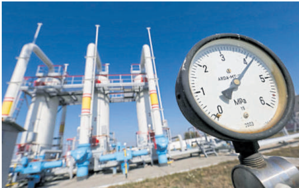
Ein Druckmessgerät der Gasverdichterstation Mryn nahe Kiew: Der Krieg in der Ukraine hat die Preise weiter in die Höhe getrieben. FOTO: DPA
